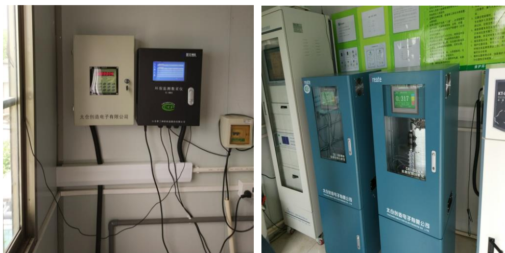
图 4 污水在线监控装置
